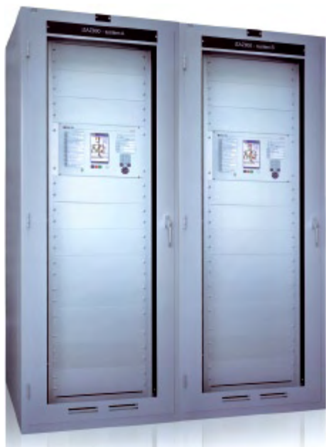
Rys. 3. Szafy zabezpieczeń iZAZ800
